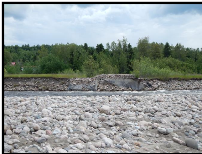
Photographie 10. Bande riveraine avec toile géotextile de stabilisation du sol visible sous l'effet de l'érosion
